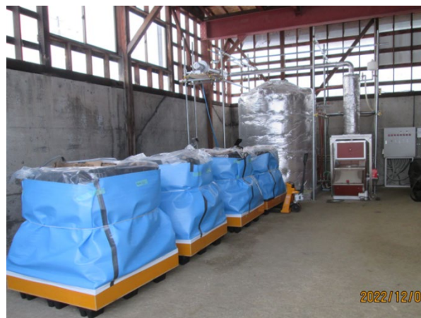
青森で導入した薪乾燥システム
