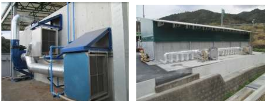
バイオマス発電所に設置した様子
